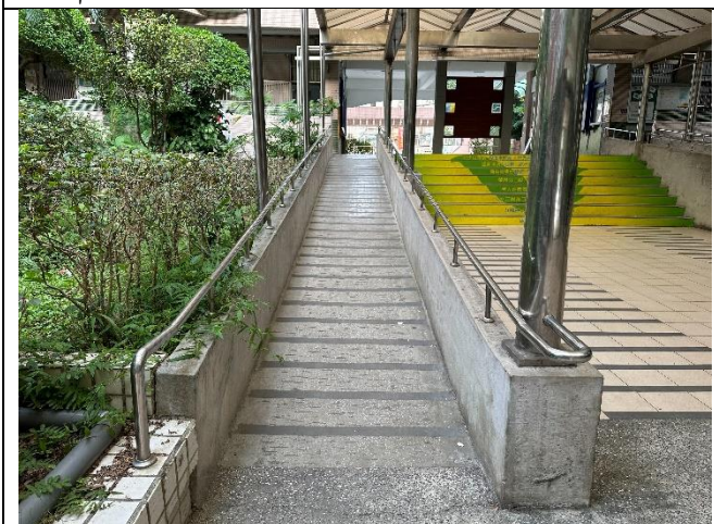
因坡度過大，過於傾斜，雨天時候常有師生跌倒，目前安裝止滑條因應。
