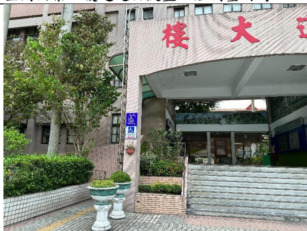
明道樓前方無障礙坡道也同樣長度不足，不符合相關規定。
